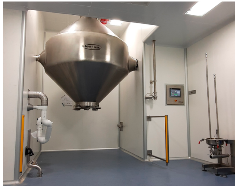
Mezclador bicónico BC-4200, diseñado para la fabricación de productos farmacéuticos e instalado en sala blanca.
