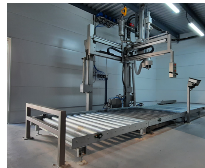
Envasadora PEN-2000-C instalada equipada con camino de rodillos motorizado para la entrada y salida de los envases.
