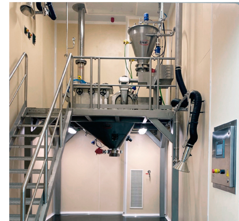
Instalación de molienda K-315-MO, preparada para trabajar en zona Atex. El equipo es alimentado mediante un sistema de transporte neumático TS-VAC 50.
